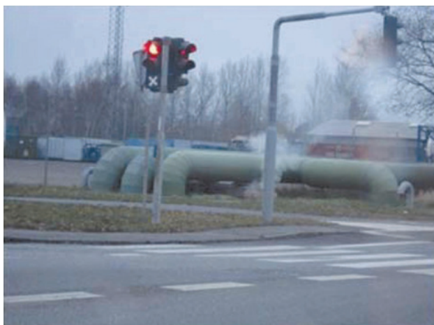
図1 デンマーク・カルンボー市内で蒸気・温水を供給する配管
